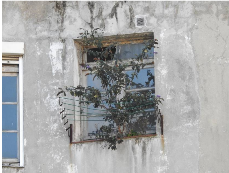
Foto 7. Budleya creciendo en una ventana de uno de los edificios a demoler.
